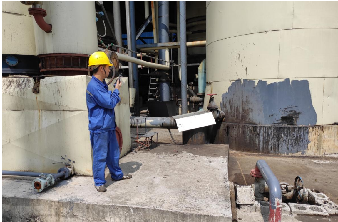
操作工巡检行至3号煤气发生炉时，发现泄漏险情立即向车间主任报告。
